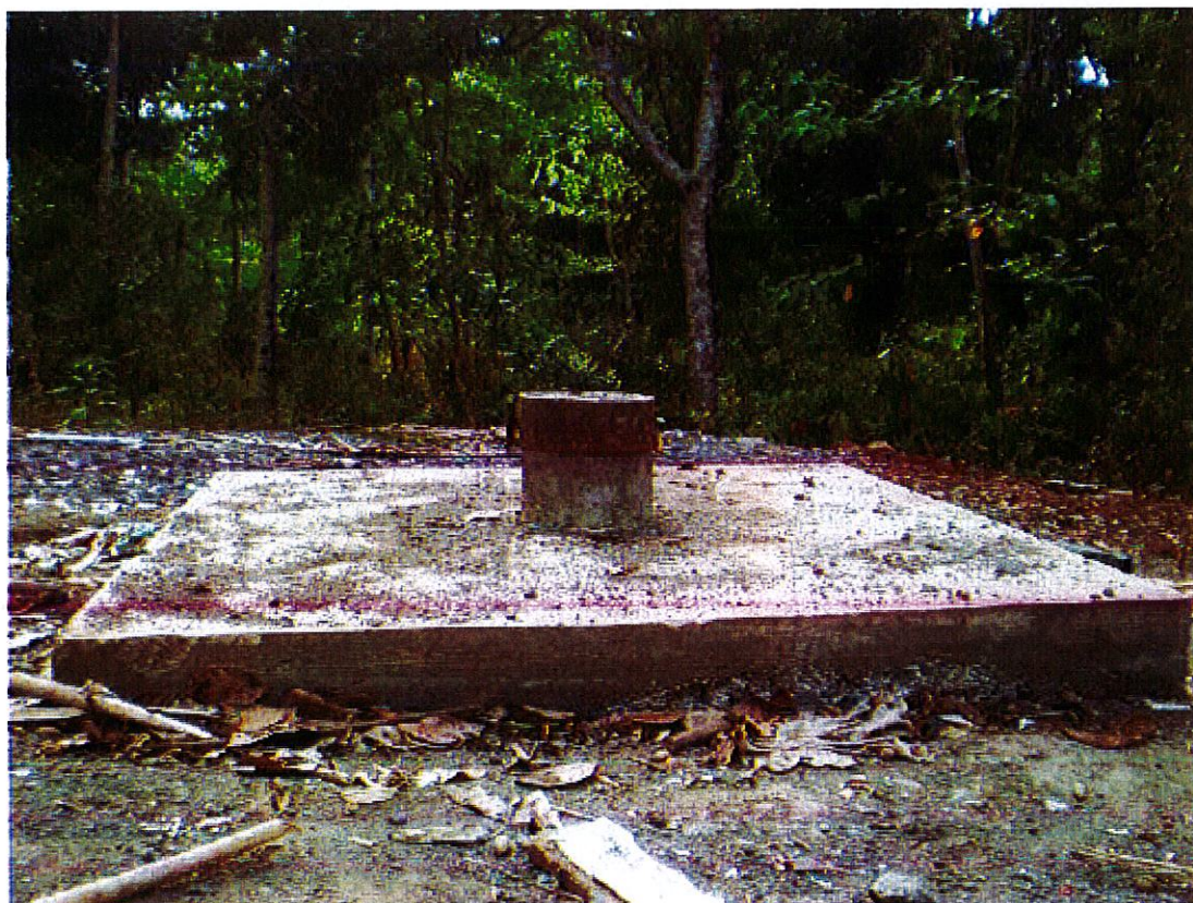
FIGURE 9 : TETE DU FORAGE MAJIMBINI AU MOMENT DES ESSAIS (OCTOBRE 2013)
